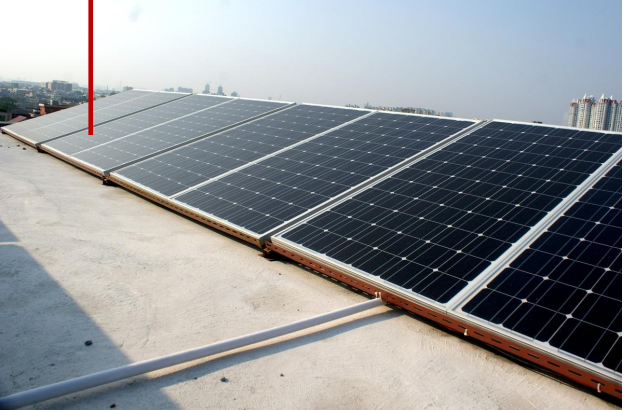
平屋面采用太阳能光伏板
