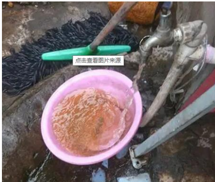
给水管道腐蚀：用水安全隐患
