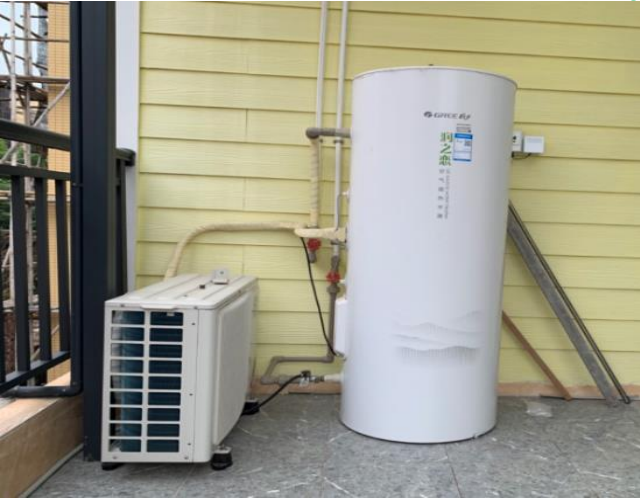
空气源热泵热水系统
