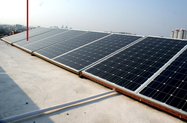
平屋面采用太阳能光伏板
