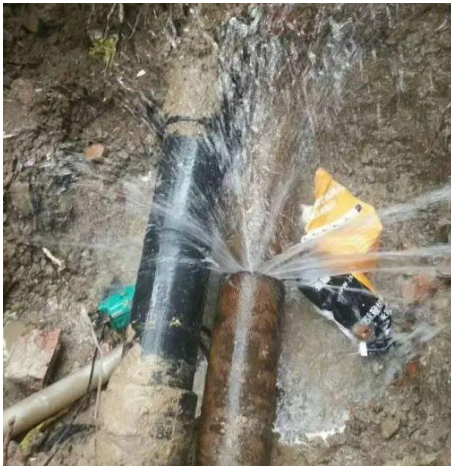
给水管道腐蚀：漏水
