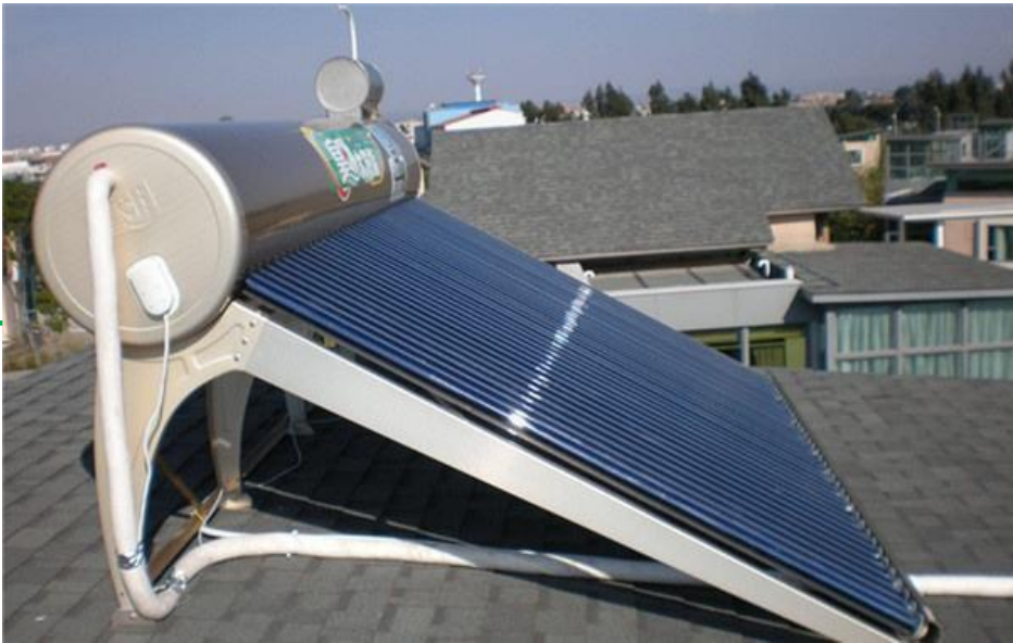
平屋面放置一体式真空管太阳能热水器
