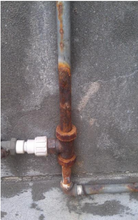
给水管道腐蚀影响饮水安全
